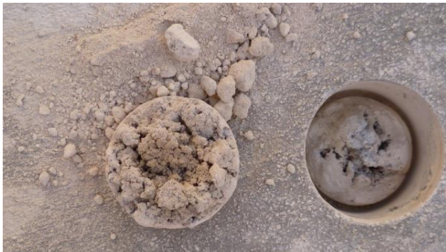
Absolut ungenügende Mörtelqualität
