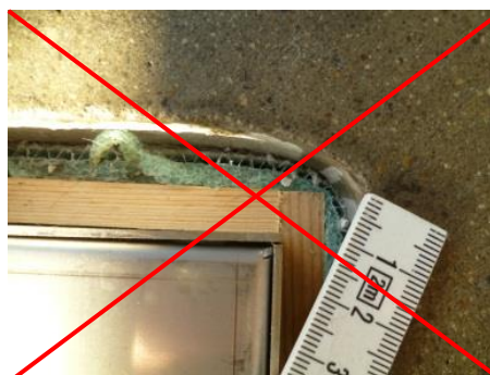
Bei so ausgebildeten Ecken kann sich der Estrich nicht mehr spannungsfrei bewegen. Risse sind zu erwarten.
